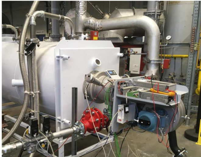
3.3. ábra: A GWI laboratóriumában lévő égőpróbapadon telepített ipari kényszeráramú égő
